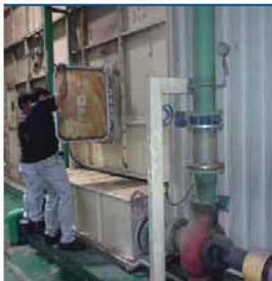
ส่วนงานควบคุมอากาศ AHU ก่อนใช้งาน IOREX
